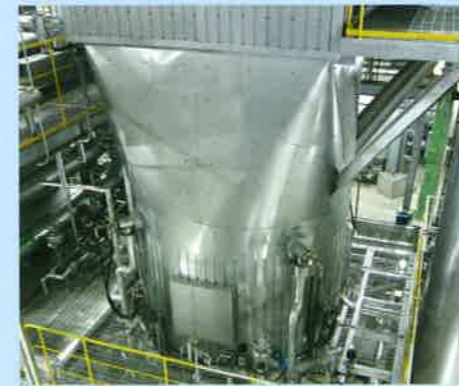
●減温塔 炉から発生した排ガスを噴射水で所定の温度まで冷却します。
