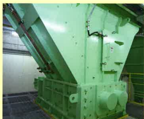
●一次破砕機 粗大・不燃ごみ受入コンベヤから供給されたごみを粗破砕します。
