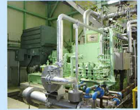
●蒸気タービン発電機 ボイラで発生した蒸気を利用して、最大870kWの発電を行います。
