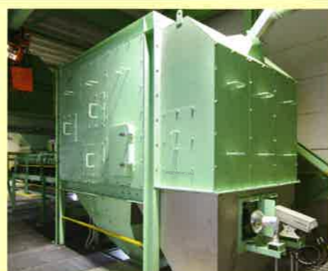
●破砕物磁選機 磁石により破砕ごみ中の鉄類を分別回収します。
