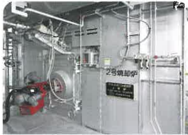
●焼却炉 焼却炉は、約850℃の高い温度で安定して焼却します。
