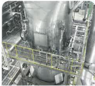
●減温塔 焼却炉から発生した排ガスの温度を下げます。
